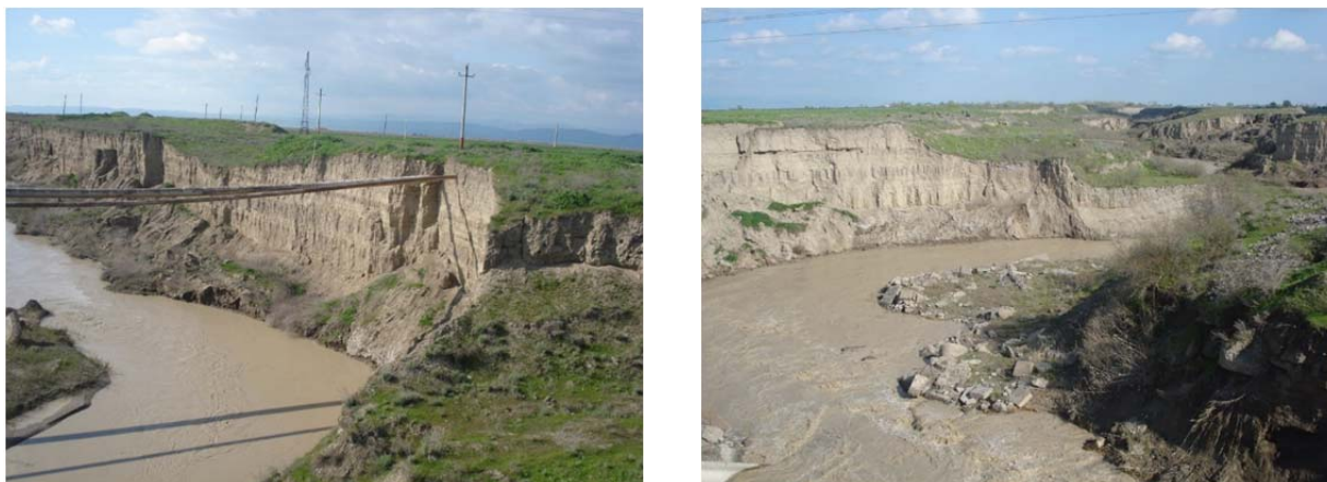
Рисунок 3 – Оползневые процессы в долине р. Агсучай Figure 3 – Landslide processes in the valley of the Agsuchai River
