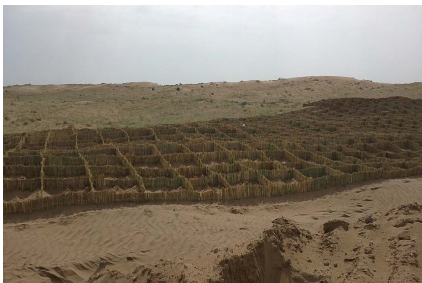
Рисунок 2 – Установленная механическая защита вдоль железной дороги
