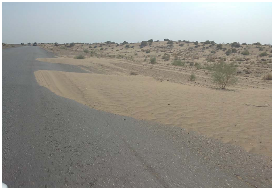
Рисунок 1 – Языковые песчаные заносы на автомобильной дороге
