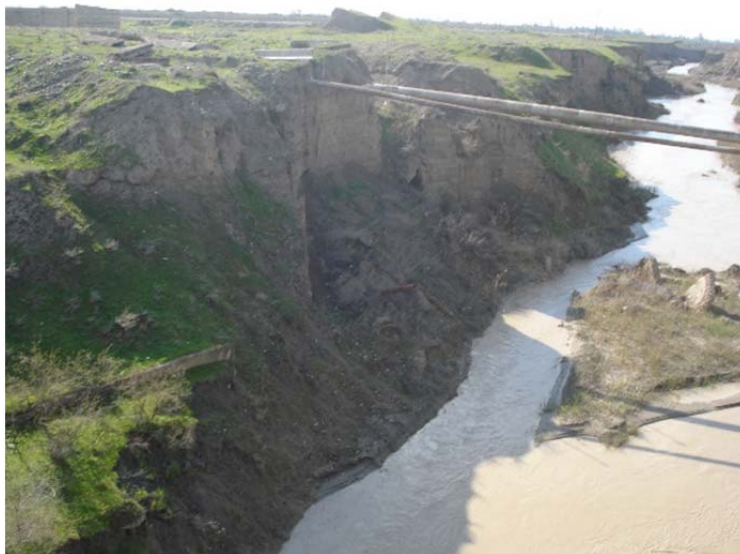
Рисунок 1 – Оползневые процессы в долине р. Пирсаатчай
