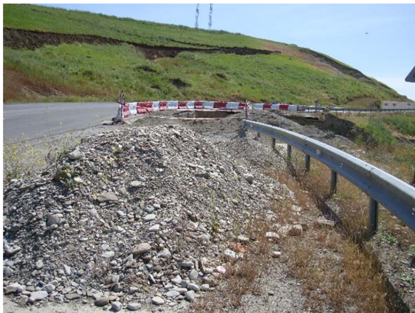
Рисунок 2 – Оползневые процессы на 106 км автодороги Баку–Гобустан–Шемаха
